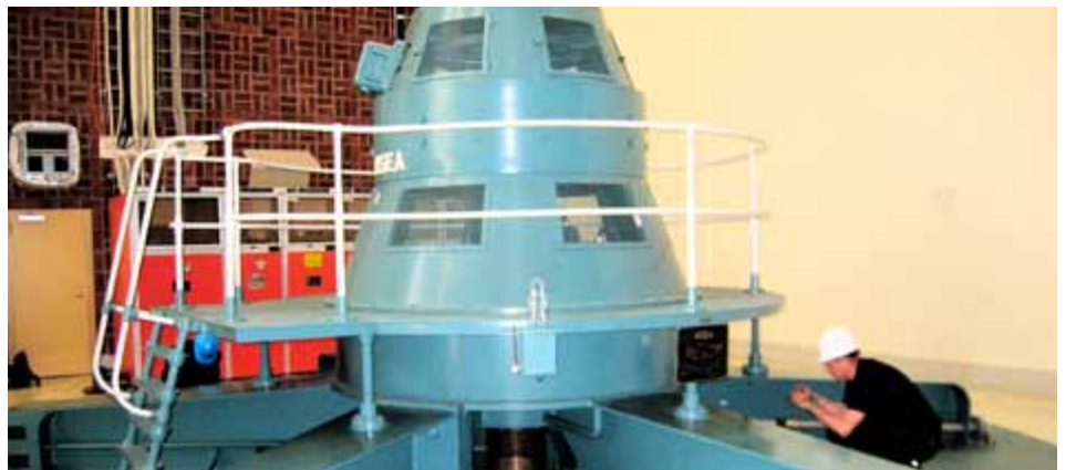
Гидрогенератор № 2 ГЭС «Партебода», для которого «РУСЭЛПРОМ» поставит оборудование
