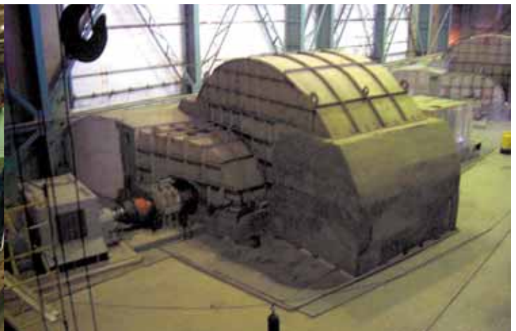
Вентиляционная установка на шахте «Воргашорская-2», оснащенная двигателем «ЛЭЗа»
